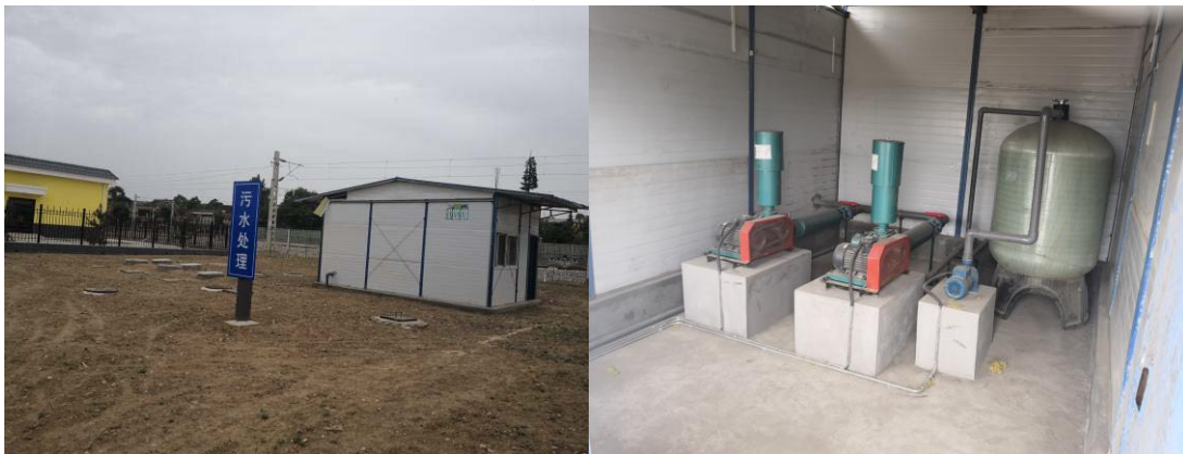
图4.1-2厂区污水处理设施照片
