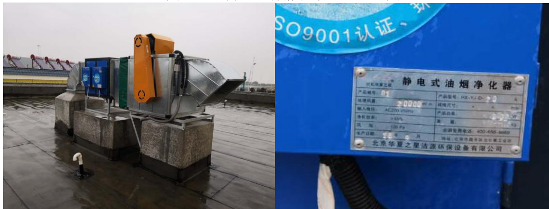
图4.1.4项目食堂油烟废气处理设施
