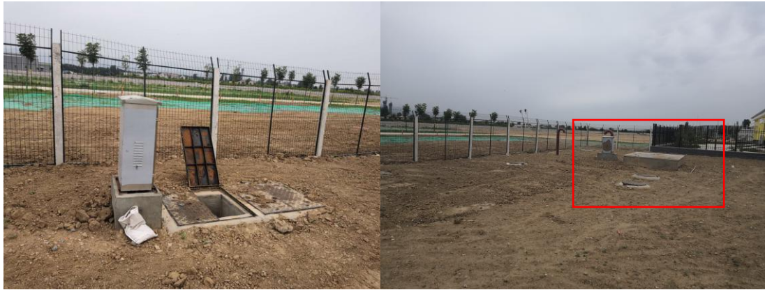
图4.2-1项目污水站进水井及清水池
